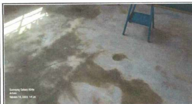
Foto 3: MANTENIMIENTO DE PISO DE CONCRETO EN MAL ESTADO
